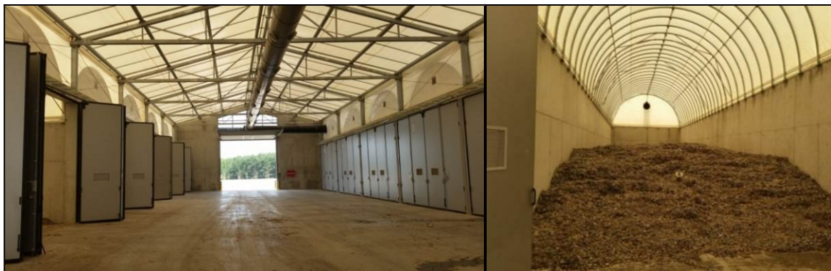
Instalacja w Balinie, suszenie RDF
