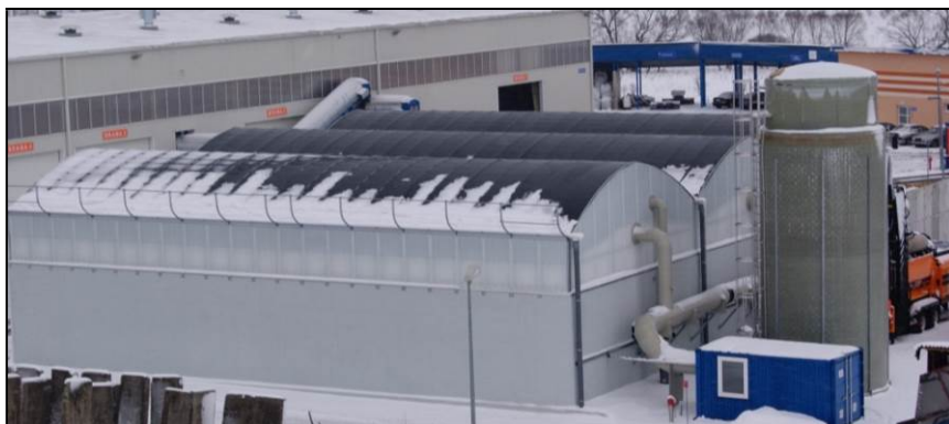
Instalacja w Lubawce
