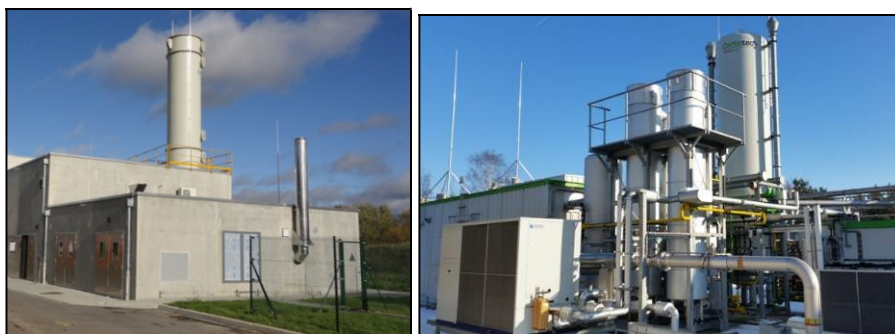
Rysunek 3.7 Waloryzacja biogazu na płuczce aminowej i desorpcji, fot. proGEO
