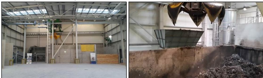
Rysunek 3.1. Przykład instalacji załadunku wsadu do fermentacji ciągłej (chwytnak), fot. proGEO
