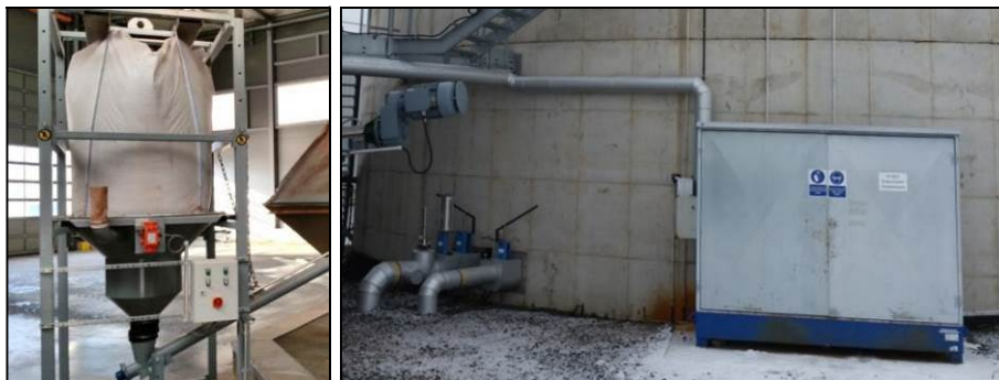
Rysunek 3.5 Instalacje dozujące wodorotlenek żelaza i chlorek żelaza, fot. proGEO
