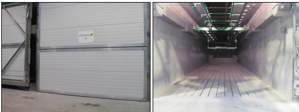
Instalacja Eggersmann w Poznaniu (bramy, reaktor z automatycznym załadunkiem wsadu)
